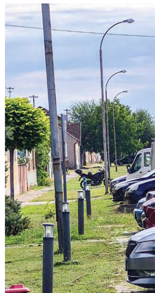
Čak i noviji dijelovi javne rasvjete zbog hrđe ne ulijevaju sigurnost
